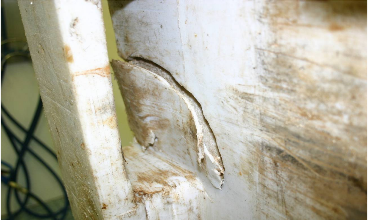
Bilde 1 Bildet viser stor revne på undersiden av containerbunnen
